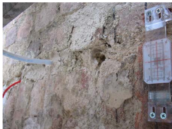
Figura 11 Particolare del consolidamento degli abbassamenti archi finestre abside con resina epossidica per iniezione.
